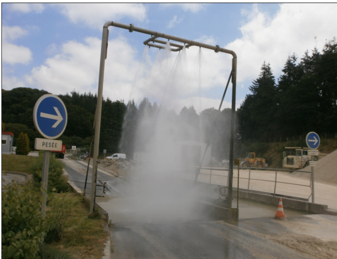
Rampe d'aspersion en sortie de site
