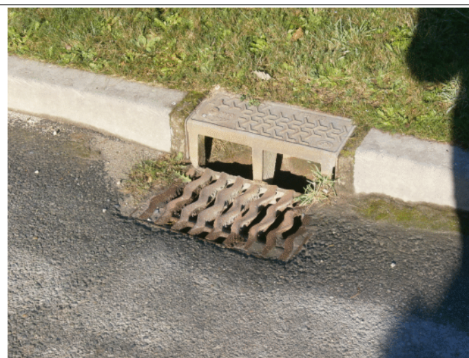
Système de collecte des eaux pluviales sur la zone technique
